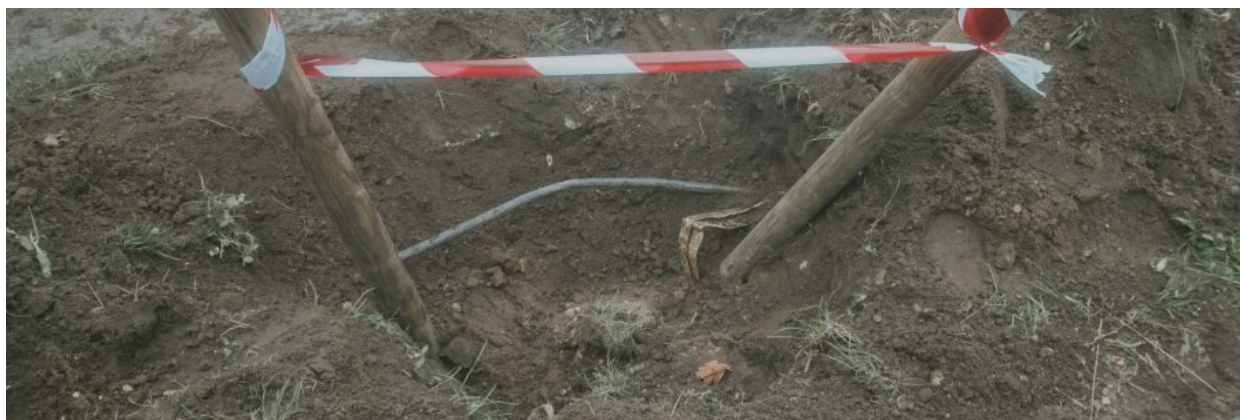
27. fotó: A közvilágítás kábel sérülése faültetése során
