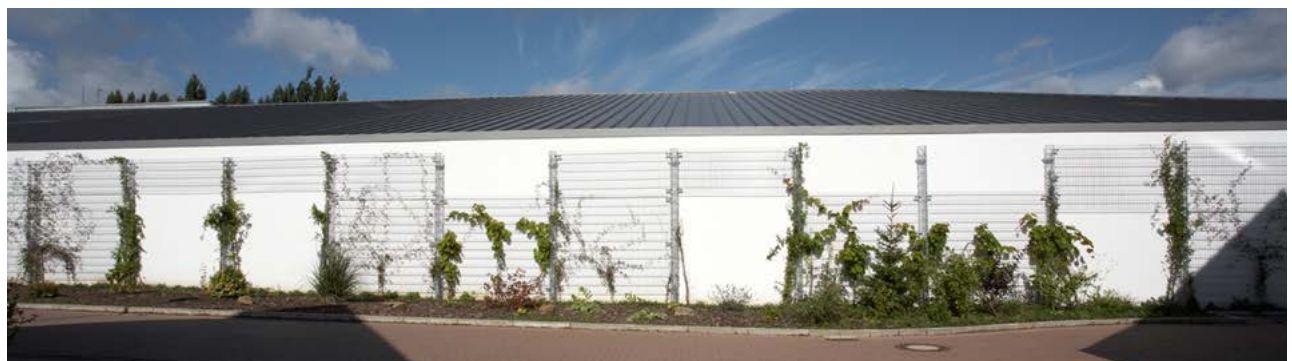
169–173. ábra Fém támszerkezetek: vízszintes acél sodronyköteles (Greenhouse, Budapest), acél sodronyhálós (Pannónia Iskola, Budapest), merev acél rácsos és közvetlenül falszerkezetre, illetve távtartóval szerelt előregyártott acél rácsos
