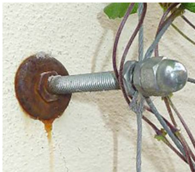
232. ábra Eleinte esztétikai, majd statikai gondot is okozhat egy nem megfelelően időjárásálló elem alkalmazása
